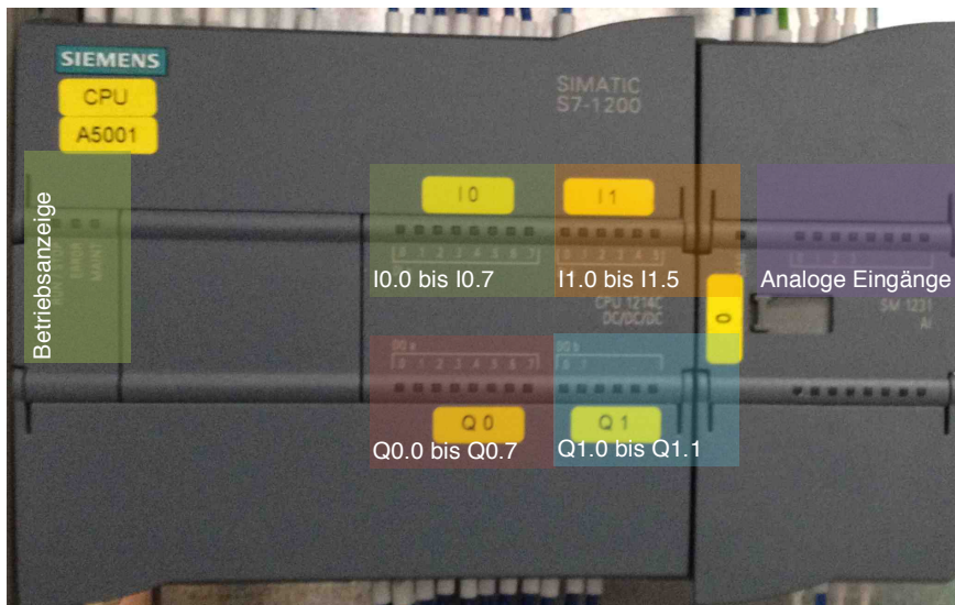
Abb. 34; Detailaufnahme SPS-Block in Steuerschrank
