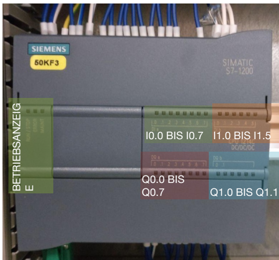
Abbildung 31: Detailaufnahme der SPS im Steuerschrank
